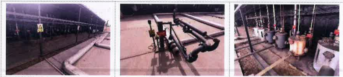
6、二氧化碳储罐及装卸区
