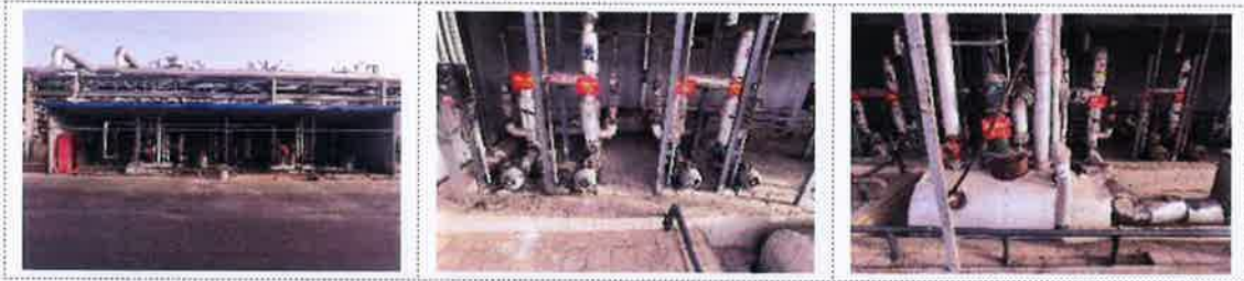
5、中间体罐组（乙类）装卸区：鹤管、传输泵。
