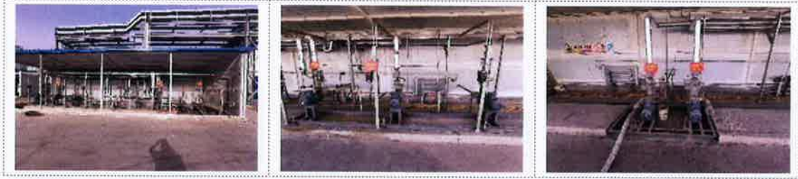
4、乙类罐区三装卸区：鹤管、传输泵。
